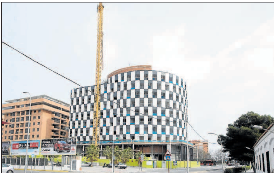
Estado de las obras del hotel, en una imagen captada ayer. GERMÁN CABALLERO
